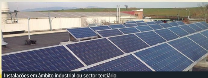
Instalações em âmbito industrial ou sector terciário
